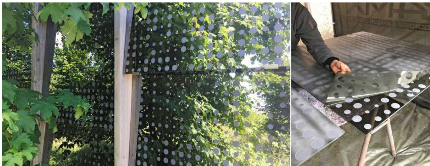
Eine nachträglich sandgestrahlte Fassade in Scharnstein: Für die Nachrüstung konnten die einzelnen stark spiegelnden Gläser von der Fassade abgenommen werden. Anschliessend wurden sie vor Ort durch partielles Sandstrahlen (lochkartenartiges Punktraster wechselnder Durchmesser) im Sinne des Vogelschutzes verändert.
